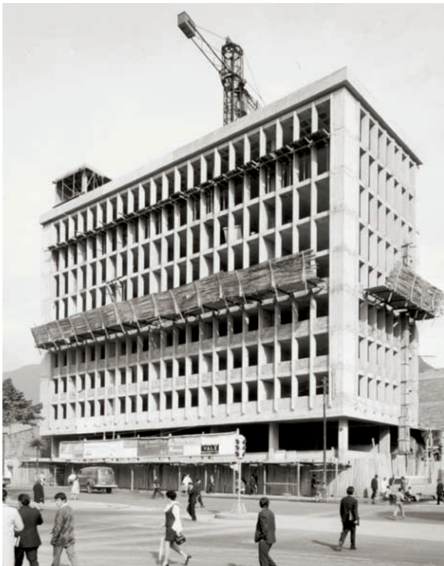
> 1970, septiembre. Edificio Banco Antioqueño en construcción. Foto: Paul Beer. Instituto Distrital de Patrimonio Cultural - Colección Museo de Bogotá
